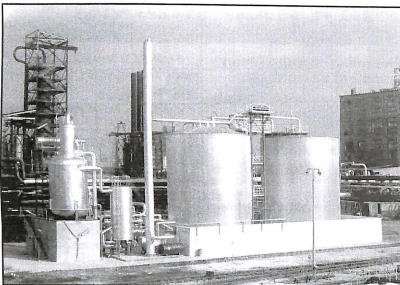
Instalacja „spod igły”
