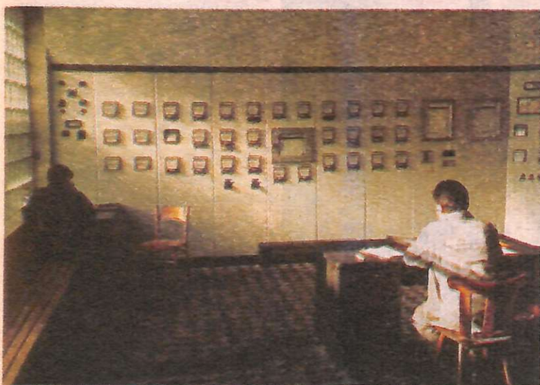
Sterownia całej instalacji.
